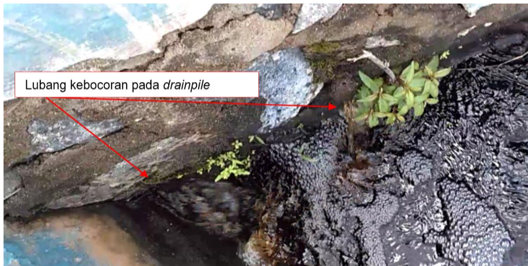
Gambar 5 Lubang kebocoran pada bagian sayap drainpile
