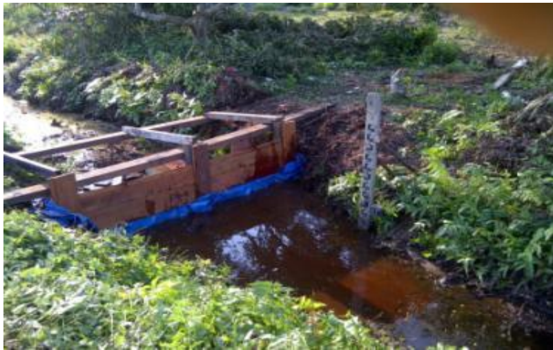
Gambar 16 Pintu air yang berfungsi sebagai canal blocking untuk menjaga elevasi muka air tanah tetap stabil pada kisaran yang dikehendaki
